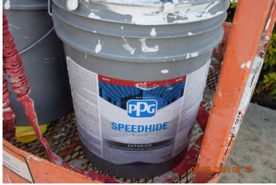
Foto 5: Material utilizado para la aplicación de segunda capa de pintura en el lado oeste del edificio 5 (E). (SPEEDHIDE 6-610XI)
