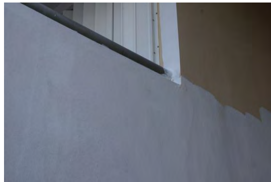
Foto 22: Se observó resanamiento de grieta vertical y aplicación de primer en el parapeto derecho del balcón izquierdo del segundo nivel. (Condición Repetitiva)
