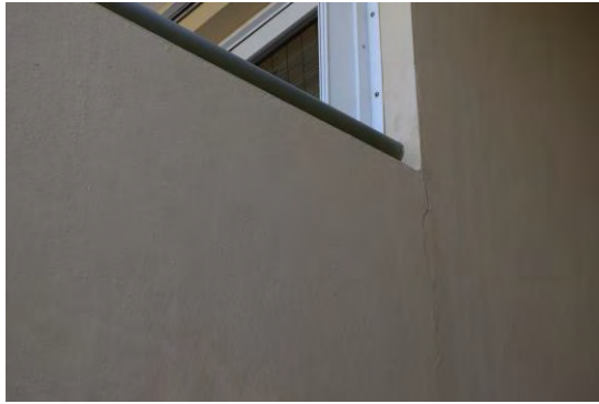
Foto 5: Se observó grieta vertical en el parapeto derecho del balcón izquierdo del segundo nivel. Esta observación se hizo en la inspección del 20 de julio del 2021. (Condición Repetitiva)
