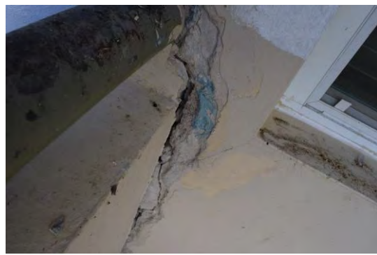
Foto 8: Vista de la grieta no común antes mencionada. La observación se hizo desde el interior del balcón.
