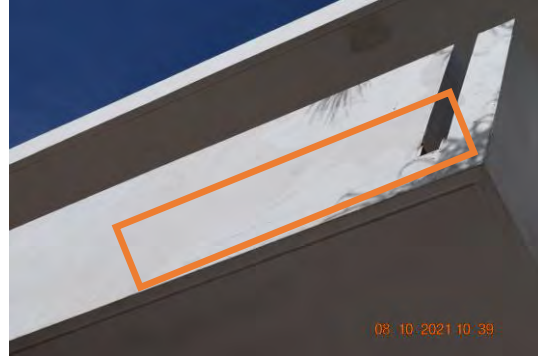
Foto 14: Se observó grieta horizontal en el parapeto del balcón de la fachada trasera del tercer nivel del edificio.
