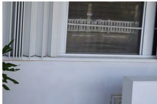
Foto 20: Se observó aplicación de calafateo alrededor del marco de las ventanas de la fachada frontal.
