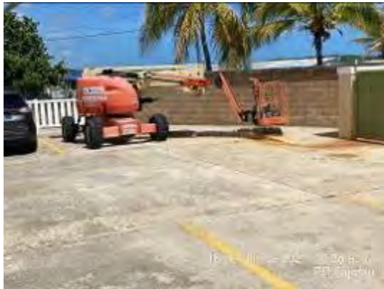
Foto 15: El contratista SP no estaba en el area de trabajo, equipo.
