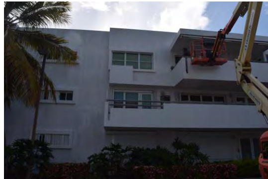
Foto 2: Se observó trabajadores realizando labor de aplicación de cemento en una grieta no común formada en el balcón del tercer nivel del lado derecho del edificio.
