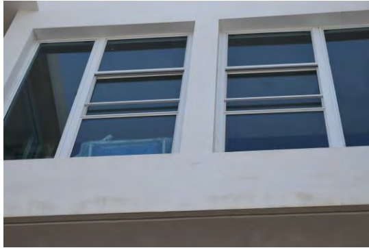
Foto 13: Se observó grieta horizontal la parte inferior del muro compartido de los apartamentos del tercer nivel. Esta observación se hizo en la inspección del 20 de julio del 2021.
