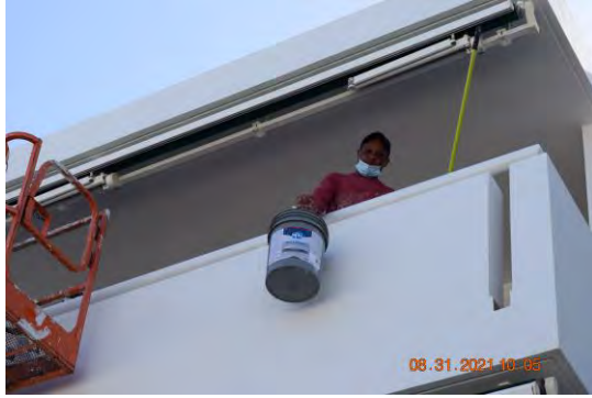
Foto 5: Se observó trabajador realizando labor de aplicación de segunda capa de pintura en los plafones y paredes de los balcones del edificio 4 (D).
