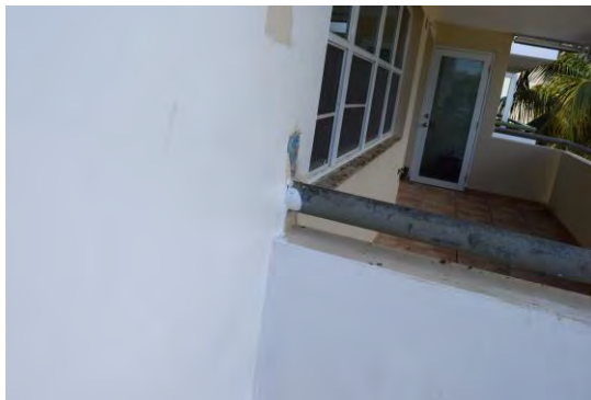
Foto 7: Se observó una grieta no común junto a parapeto izquierdo del balcón de un apartamento del tercer nivel del lado derecho del edificio.
