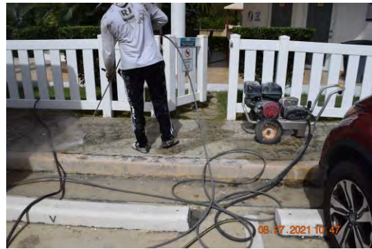
Foto 4: Se observó trabajador realizando labor de limpieza, pasando máquina de presión, en la acera del área común de la piscina.
