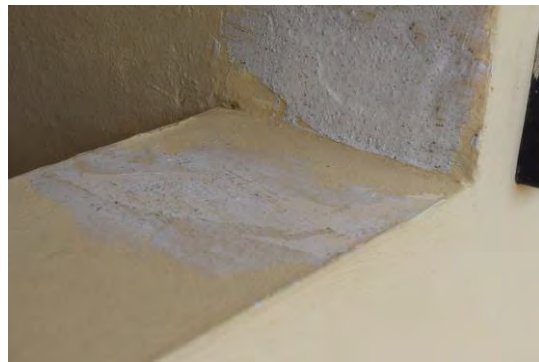
Foto 26: Se observó resanamiento de delaminación existente en el muro del apartamento izquierdo del tercer nivel.
