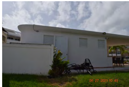
Foto 6: Se observó el edificio de los baños del área común de la piscina terminado completamente con labores de pintura.
