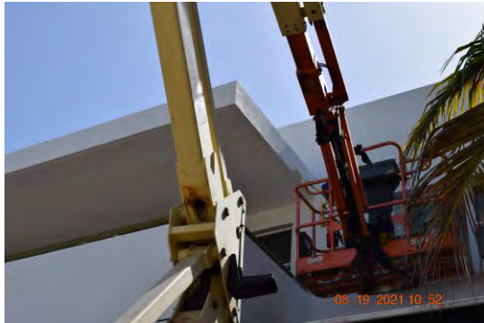
Foto 5: Se observó trabajador realizando labor de aplicación de pintura en alero sobre balcón del tercer nivel en el lado este del edificio.
