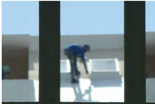
Foto 4: Evidencia de empleado realizando labor en superficie inclinada sin equipo de seguridad de arnés.
