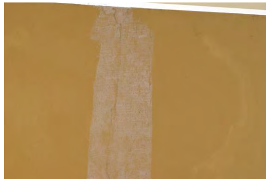
Foto 16: Se observó resanamiento de varias grietas verticales en los muros de las áreas compartidas de las escaleras y recibidores de apartamentos del edificio. (Condición Repetitiva).
