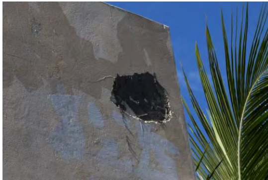
Foto 11: Se observó relleno fresco de hormigón en la zona del parapeto del edificio.
