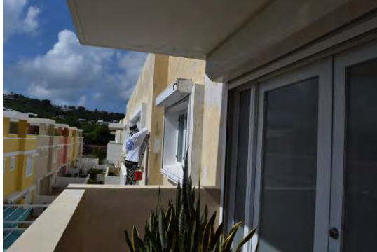
Foto 27: Se observó trabajador realizando labor de enmasillado sobre las grietas de la fachada trasera del edificio.
