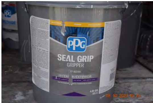
Foto 11: Material utilizado para labor de aplicación de primer en el edificio. (SEAL GRIP GRIPPER 17-921 XI)
