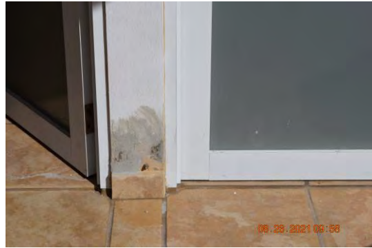
Foto 7: Se observó que se realizó labor de resanamiento de grietas en algunas áreas de la estructura de los baños en áreas comunes de la piscina.
