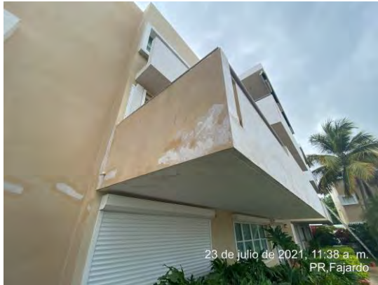
Foto 5: Se observó que se realizó reparación de grietas en el lado oeste del edificio.
