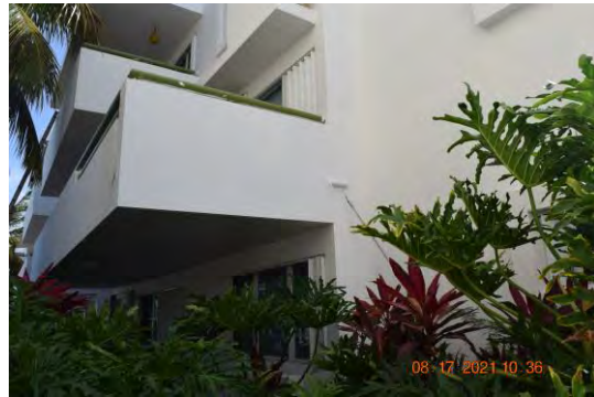
Foto 2: Se observó trabajadores realizando labor de aplicación de pintura en el lado norte del edificio.
