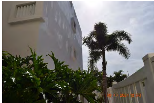
Foto 2: Se observó en la fachada derecha del edificio pintura fresca.
