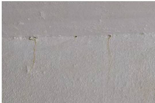
Foto 4: Se observó posible mancha de corrosión en una zona entre el muro y losa de techo en el tercer nivel del edificio junto a las escaleras.
