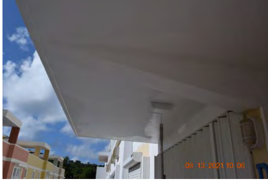
Foto 5: Se observó trabajador realizando labor de aplicación de pintura en techo interior del edificio.
