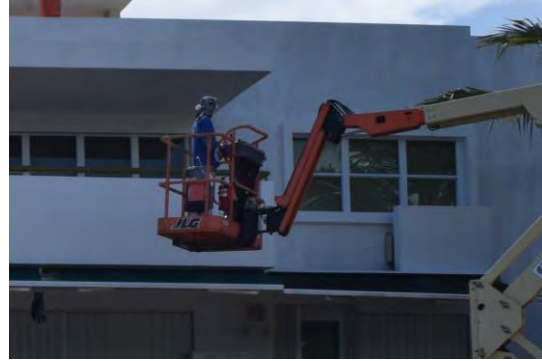
Foto 6: Se observó a trabajador utilizando el elevador de brazo articulado para acceder al espacio de la terraza para realizar labor de resamamiento de grietas en los parapetos del edificio.
