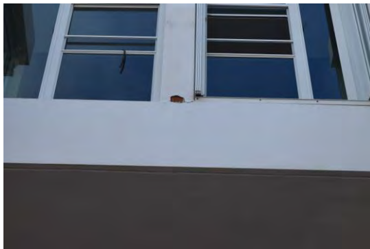
Foto 3: Se observó grieta horizontal y delaminación de capa superficial del muro que divide los apartamentos del tercer nivel del edificio. Esta observación fue realizada en la inspección del 3 de agosto del 2021.
