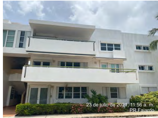
Foto 15: Se observó que se realizó aplicación de primer en el lado oeste del edificio.
