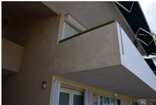
Foto 11: Se observó grieta vertical en el parapeto izquierdo del balcón derecho del segundo nivel. Esta observación se hizo en la inspección del 20 de julio del 2021. (Condición Repetitiva)
