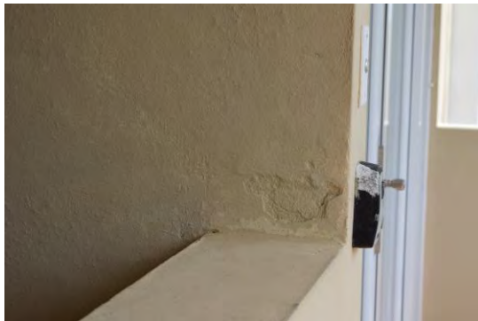
Foto 25: Se observó delaminación existente en el muro del apartamento izquierdo del tercer nivel. Esta observación se hizo en la inspección del 20 de julio del 2021.
