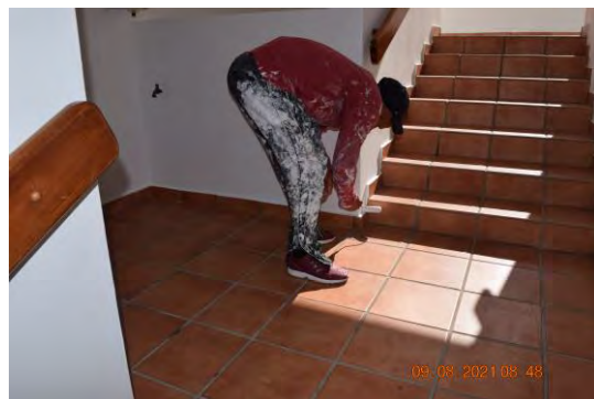
Foto 4: Se observaron trabajadores realizando labores de aplicación de pintura en los recortes de los muros del edificio 3 (C).
