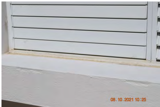
Foto 7: Se observó detalle por corregir de desprendimiento en el marco que rodea la ventana.
