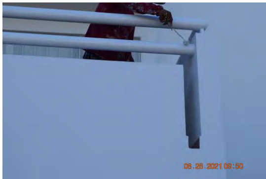
Foto 3: Se observó trabajador realizando labor de acondicionamiento de superficies de metal en balcón del edificio 5 (E).
