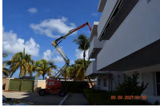
Foto 2: Se observó elevador de brazo articulado para los trabajadores acceder el nivel del techo del edificio para realizar labor de aplicación de segunda capa de pintura en el lado oeste.
