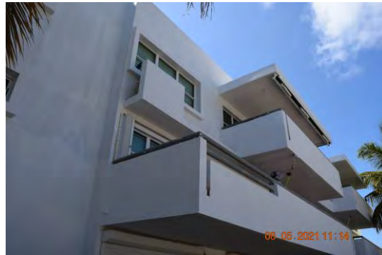
Foto 2: Se observó trabajador realizando labor de aplicación de pintura en balcón del segundo nivel en el lado izquierdo del edificio.
