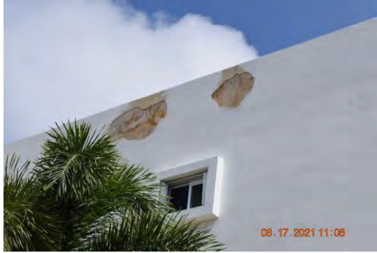
Foto 5: Se observó pedazos de empañetado desprendidos del parapeto del lado norte del edificio. Los mismos tienen una dimensión de 5ft x 4ft el de la izquierda y de 4ft x 3ft el de la derecha.
