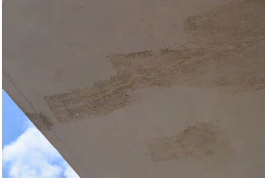
Foto 17: Se observó resanamiento de grietas en la parte inferior de la losa de techo sobre los apartamentos del tercer nivel.
