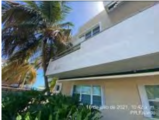
Foto 1: El contratista SP no estaba en el área de trabajo, se observó que realizó limpieza con máquina de presión en el lado este del complejo
