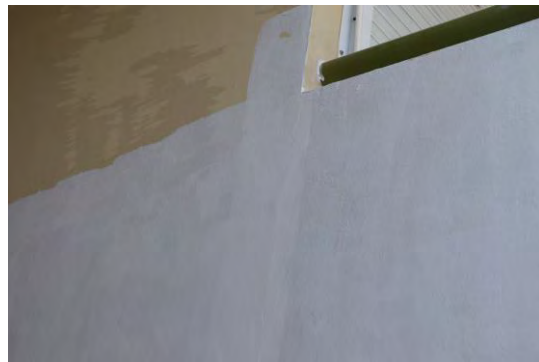
Foto 12: Se observó resanamiento de grieta vertical y aplicación de primer en el parapeto izquierdo del balcón derecho del segundo nivel. (Condición Repetitiva)
