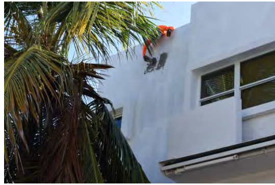
Foto 10: Se observó trabajador realizando labor de aplicación de hormigón en zonas requeridas del parapeto del edificio.
