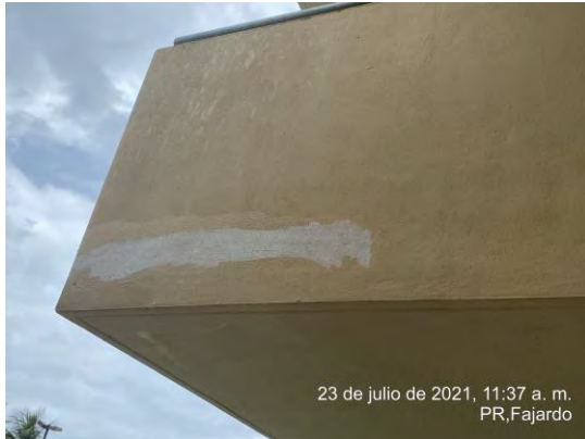
Foto 3: Se observó que se realizó reparación de grietas en el lado oeste del edificio.
