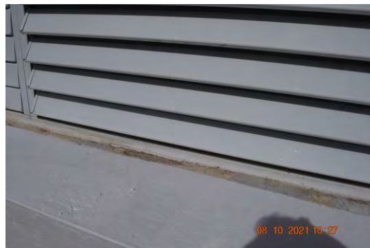
Foto 8: Se observó calafateo viejo sin remover en el borde de una ventana trasera del edificio.
