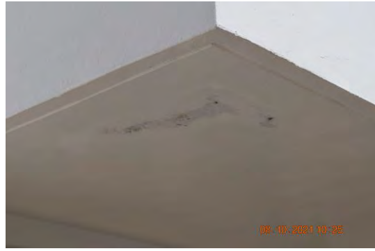
Foto 6: Se observó detalle por corregir durante la aplicación de pintura en la superficie inferior de la losa del balcón del segundo nivel.
