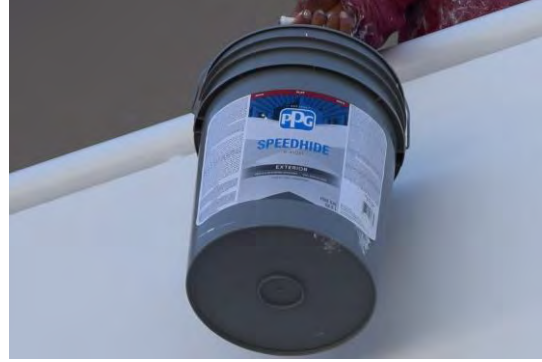
Foto 6: Material utilizado para la aplicación de segunda capa de pintura en las paredes y plafones en los balcones del edificio 4 (D).
