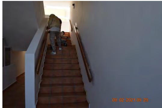
Foto 2: Se observaron trabajadores realizando labores de aplicación de pintura en los recortes de los muros del edificio 3 (C).
