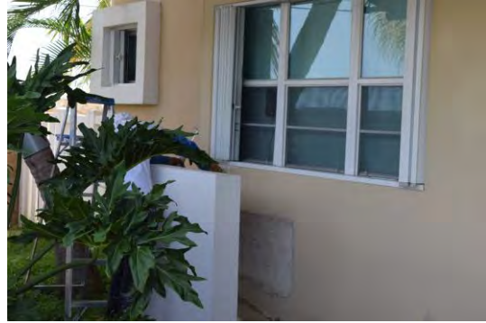
Foto 2: Se observó a un trabajador realizando labor de aplicación de calafateo alrededor del marco de las ventanas de la fachada frontal del edificio 5 (E).
