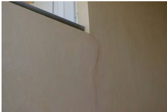
Foto 21: Se observó grieta vertical en el parapeto derecho del balcón izquierdo del segundo nivel. Esta observación se hizo en la inspección del 20 de julio del 2021. (Condición Repetitiva)
