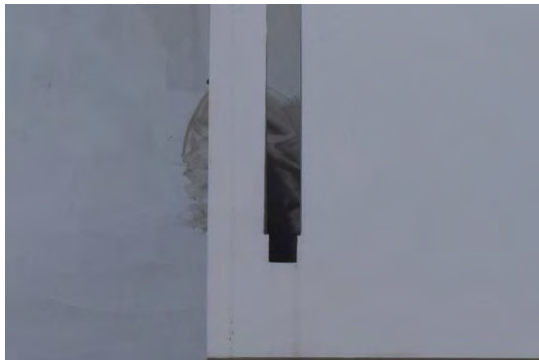
Foto 3: Percepción de la grieta corregida con cemento en el balcón del tercer nivel el lado derecho del edificio.
