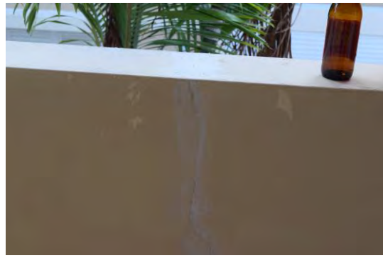
Foto 24: Se observó resanamiento de grieta vertical en el parapeto del recibidor compartido entre los apartamentos del segundo nivel del edificio.
