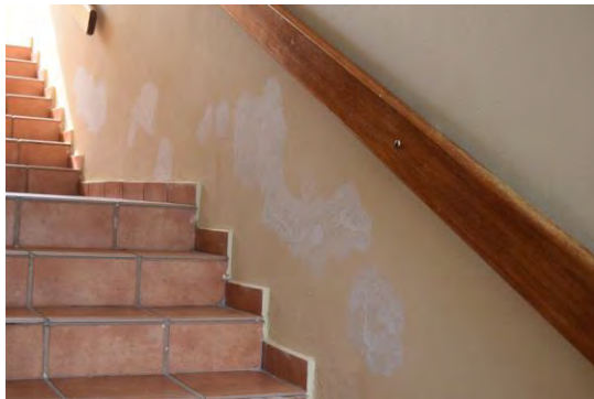
Foto 15: Se observó resanamiento de varios mapas en los muros de las áreas compartidas de las escaleras del edificio. (Condición Repetitiva).
