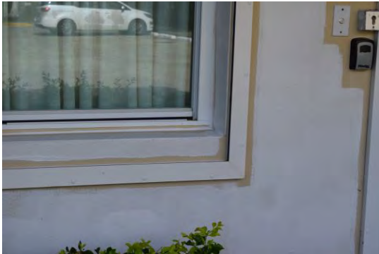
Foto 3: Se observó aplicación de calafateo alrededor del marco de las ventanas de la fachada frontal.
