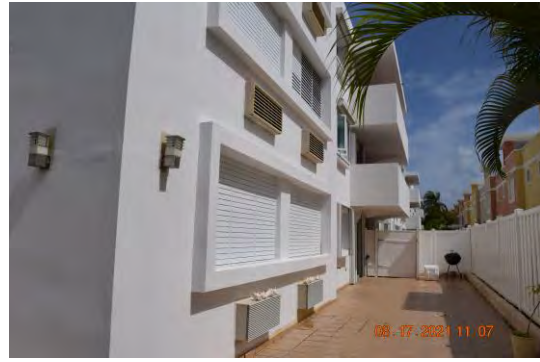
Foto 6: Se observó parte del edificio con ambas capas de pintura en el lado oeste del edificio.
