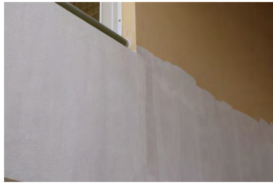
Foto 6: Se observó resanamiento de grieta vertical y aplicación de primer en el parapeto derecho del balcón izquierdo del segundo nivel. (Condición Repetitiva)
