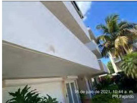
Foto 10: El contratista SP no estaba en el área de trabajo, se observó que realizó limpieza con máquina de presión en el lado este del complejo.
